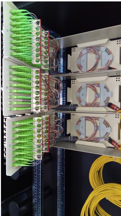
SI.6 Primer vodjenja kablova unutar razdelnika
